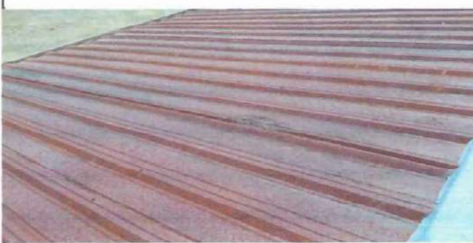
Foto 2: Laminas muy fragiles por el deterioro del material.
