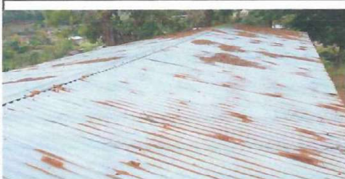
Foto 3: Techo de otro de los salones por el tipo de lamina presenta perforaciones en su estructura y hace que filtre el agua hacia el ambiente
