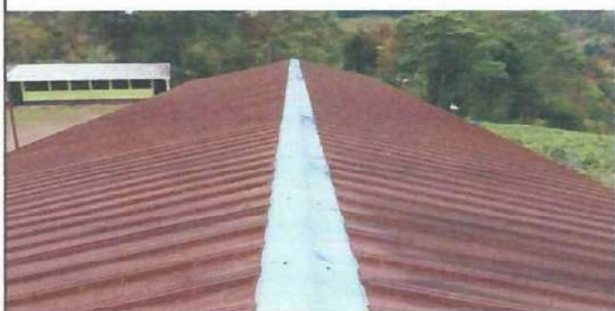
Foto 1: Techo del modulo compuesto por 4 aulas mas direccion y bodega con bastante corrosión
