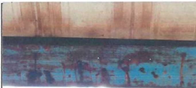
Foto 4: Canales perforados por la corrosión
